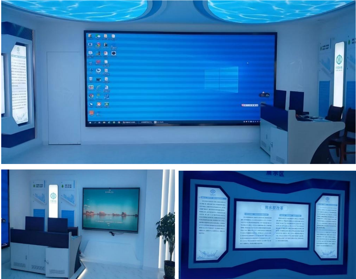
图 1.2.4-10 青铜峡市调度中心硬件设施现状
