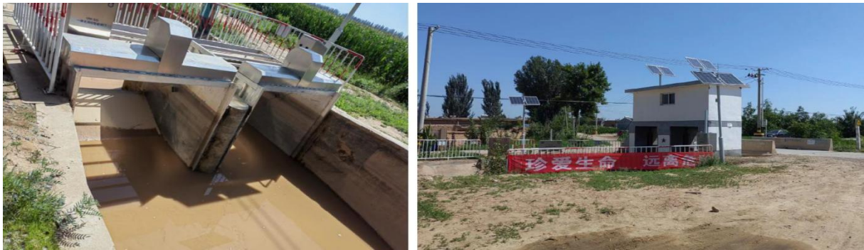
图 1.2.4-1 双龙渠已安装测控一体化闸门的节制闸和进水口
