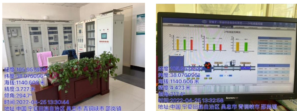
图 1.2.4-2 甘城子一泵站自动化现状
