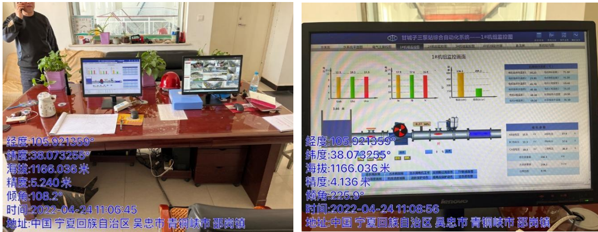
图 1.2.4-4 甘城子三泵站自动化现状
