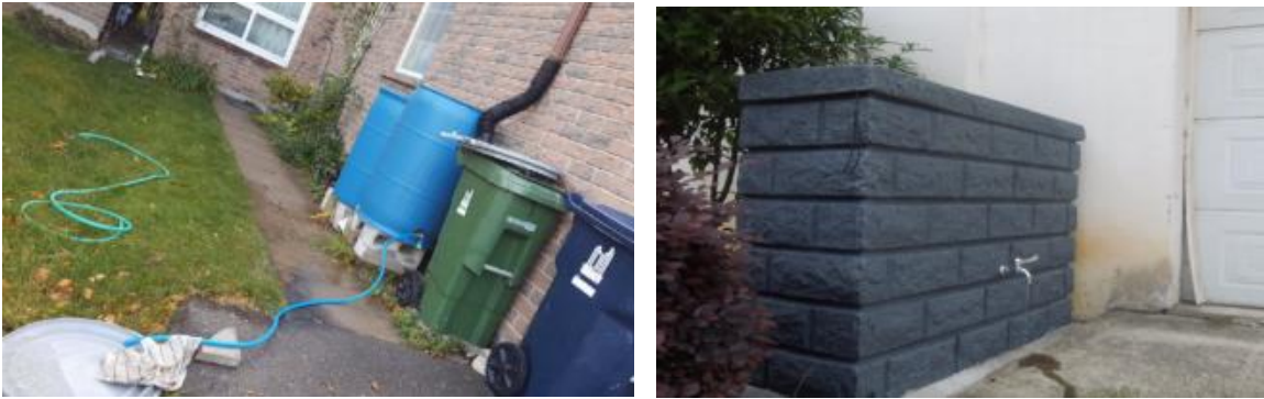
图 5-17 屋面雨水收集设施
